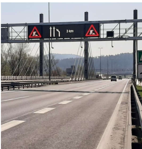
Slika 31: Spremenljiva prometna signalizacija.
